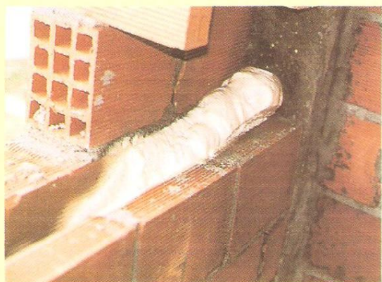
isolamento por vazamento em caixas de ar de alvenaria
